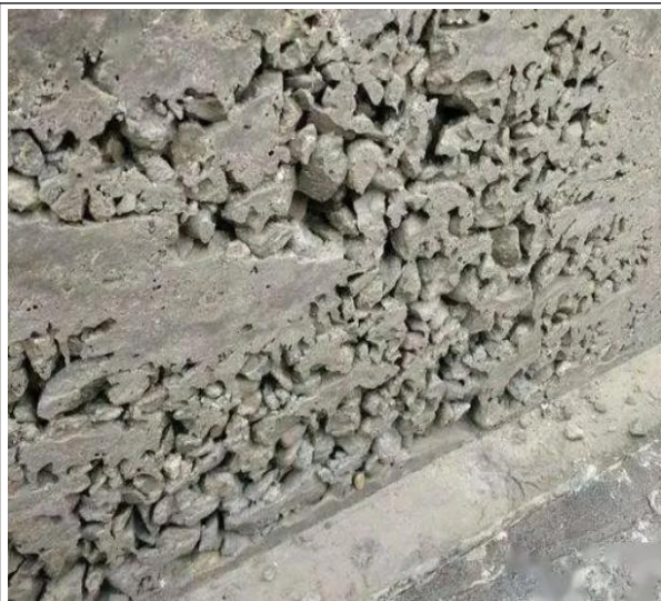
图 4-14 混凝土结构墙体蜂窝缺陷
