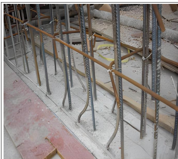
图 2-20 墙体钢筋偏位
