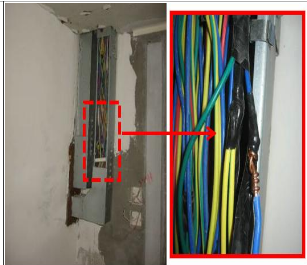
图 13-48 桥架内导线凌乱、存在接头
