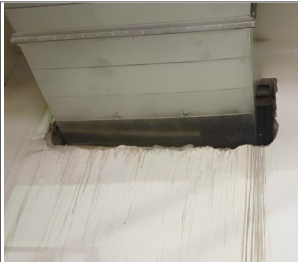
图 14-11 穿墙风管未封堵
