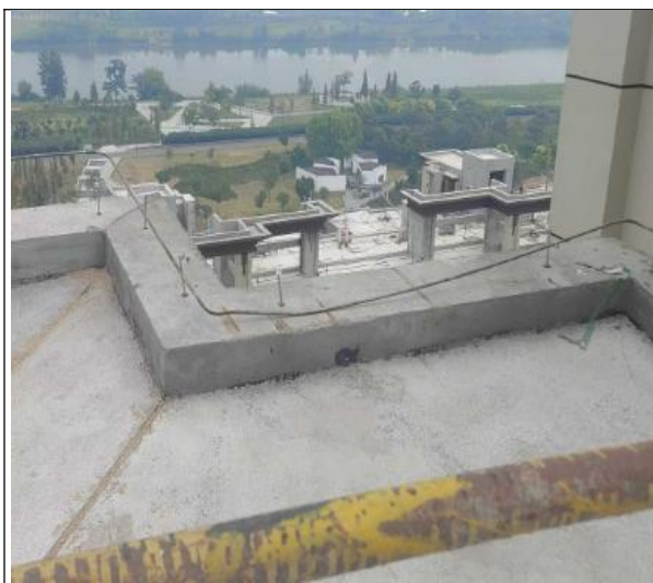
图 13-58 避雷带变形脱落
