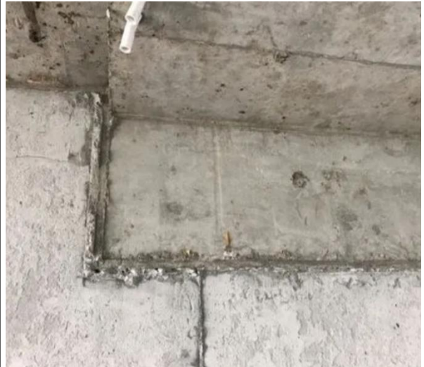
图 4-21 墙梁交接处混凝土尺寸偏差缺陷
