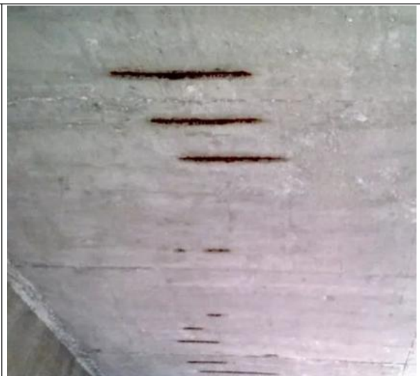
图 4-11 混凝土结构楼板露筋缺陷
