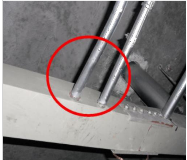
图 13-33 金属线管与桥架未跨接
