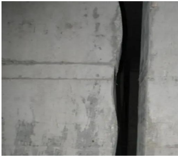
图 4-20 变形缝两侧框架柱涨模缺陷
