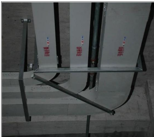
图 13-45 桥架转弯处设固定支架
