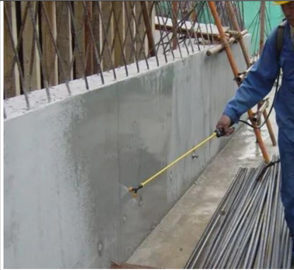
图 4-38 楼层墙喷洒养护剂养护
