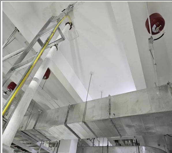
图 14-1 排烟管道未设置防火措施
