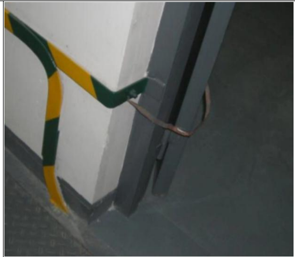
图 13-69 钢制防火门接地
