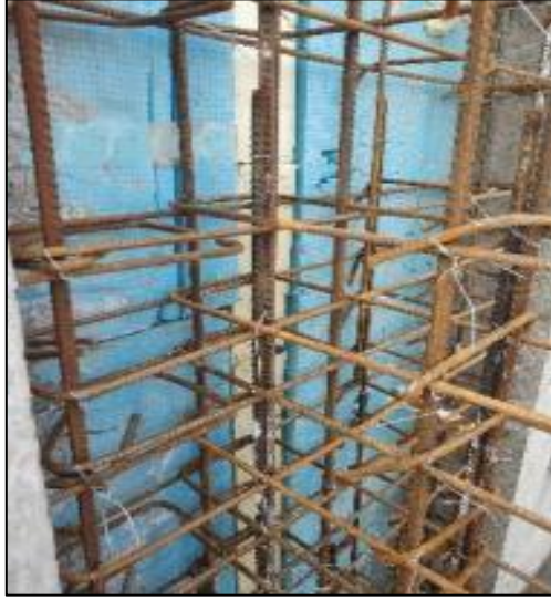
图 7-17 核心区箍筋绑扎不到位
