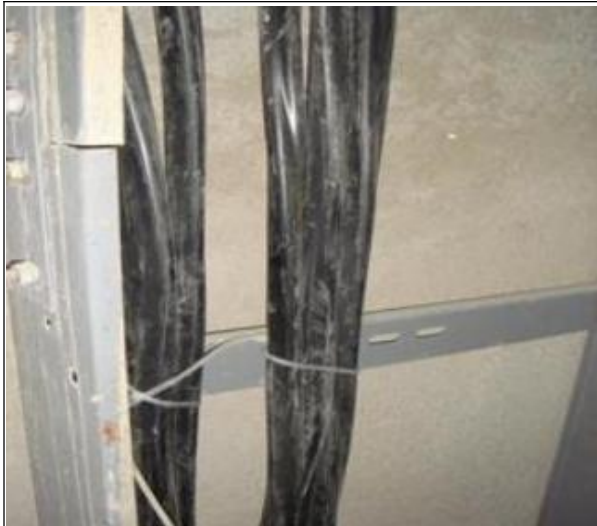
图 13-47 桥架内电缆绑扎固定不规范无标识牌
