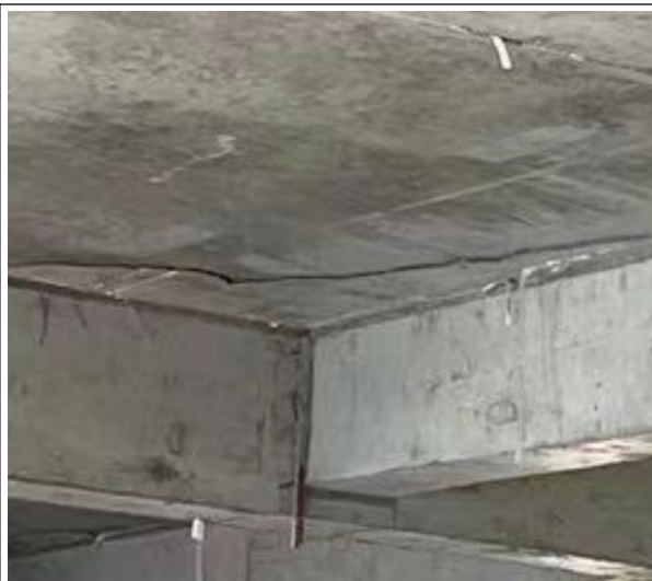
图 7-4 叠合板与现浇梁缝处漏浆
