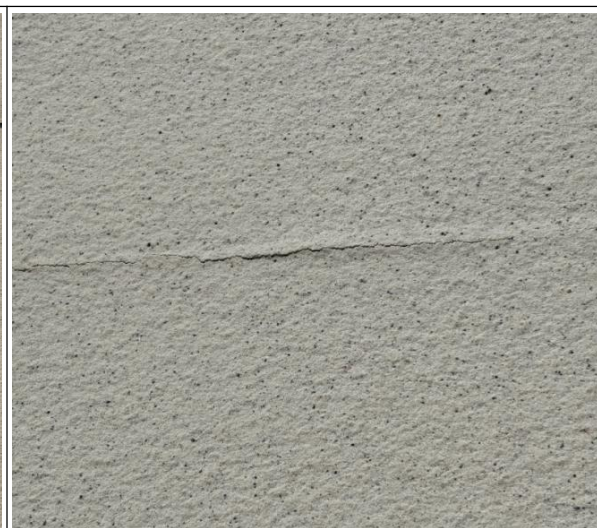
图 11-34 外墙真石漆开裂
