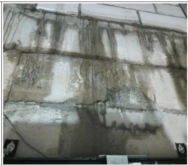
图 5-7 电梯井道内渗漏
