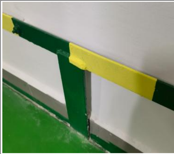
图 13-64 焊接搭接长度不足
