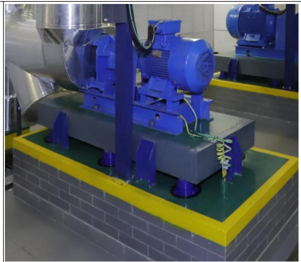
图 12-26 设备安装实例
