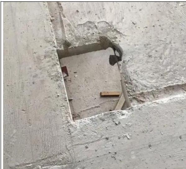
图 4-24 混凝土楼板预留洞口尺寸缺陷
