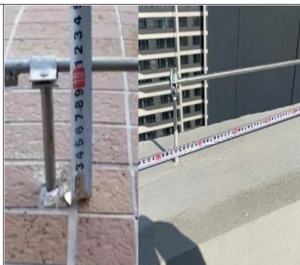
图 13-59 支架高度、间距不足
