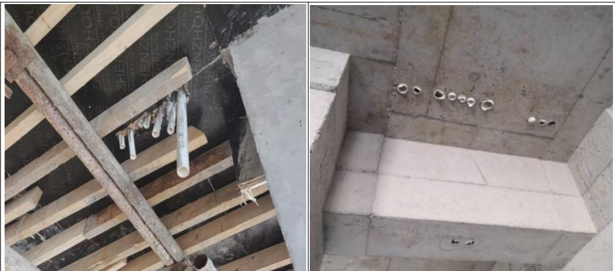
图 13-1 梁、板下翻线管断管
