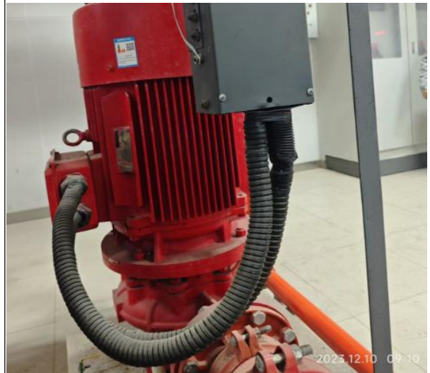
图 13-52 软管连接未采用专用接头
