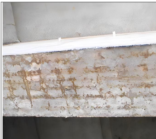
图 2-22 保护层不够梁底漏筋
