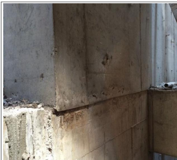
图 4-3 混凝土结构层间错台缺陷
