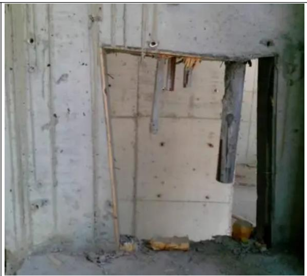
图 4-25 混凝土结构门洞尺寸偏差缺陷
