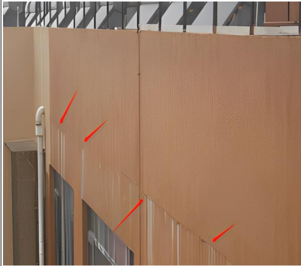
图 10-28 女儿墙根渗水
