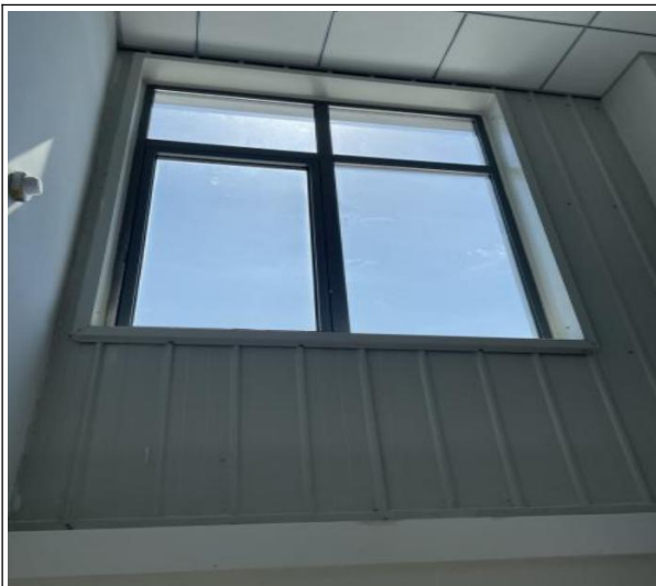
图 14-9 楼梯间排烟窗未设置手动开启装置
