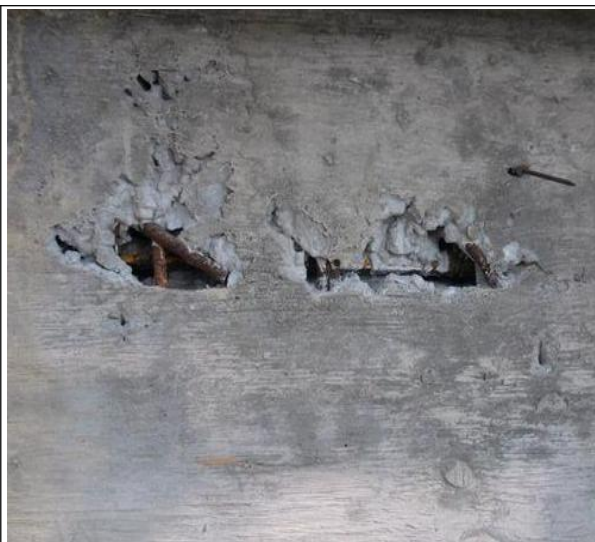
图 4-10 混凝土结构墙体露筋缺陷
