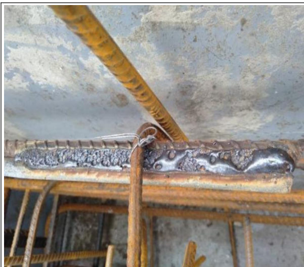
图 13-55 接地跨接线焊接质量差，焊渣未清理
