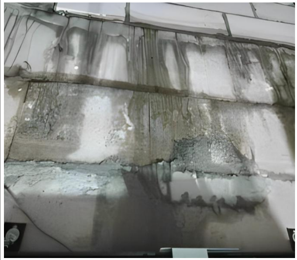
图 10-29 屋顶电梯井道渗水
