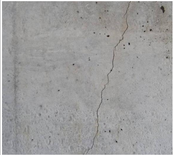
图 4-37 混凝土墙体裂缝缺陷
