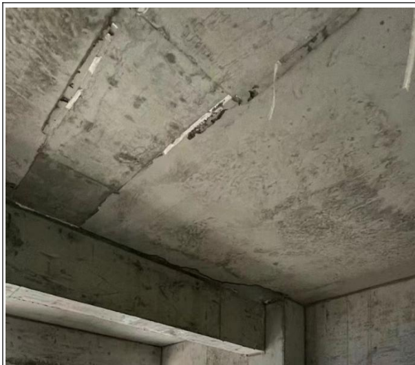
图 7-3 叠合板板带漏浆
