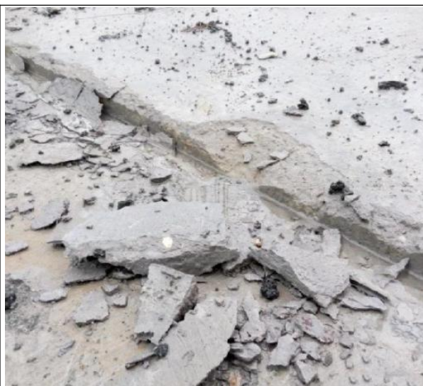
图 4-17 混凝土结构降板缺棱掉角缺陷
