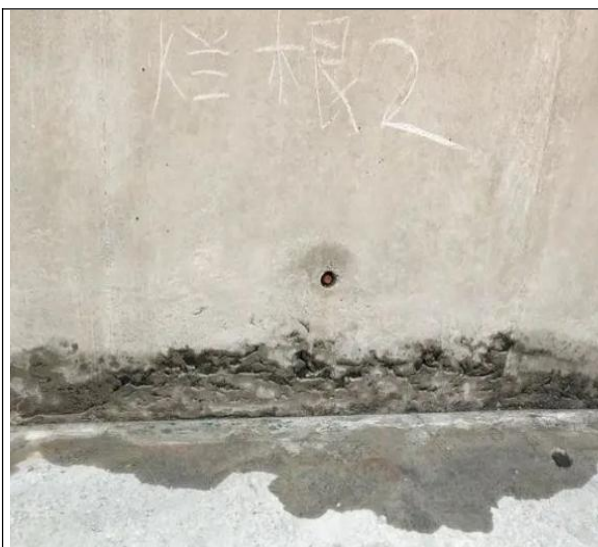
图 4-7 混凝土结构烂根缺陷
