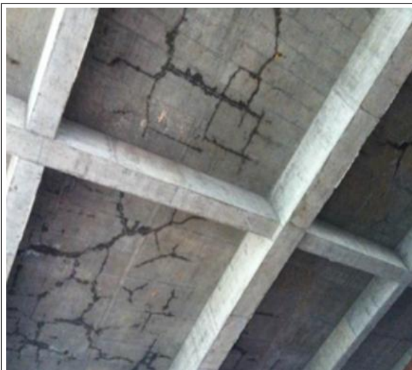
图 4-40 混凝土结构楼板裂缝缺陷
