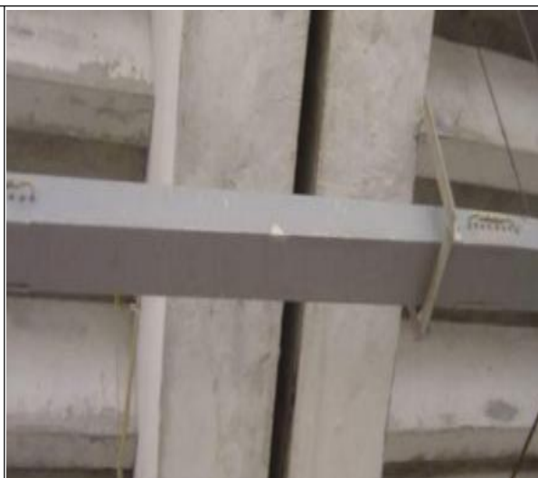
图 13-40 桥架直接穿越变形缝
