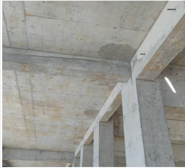
图 4-28 混凝土结构梁柱节点拦截不到位缺陷
