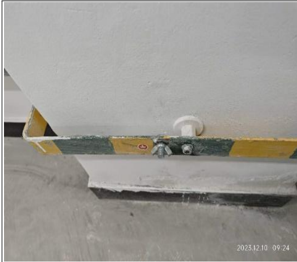
图 13-68 接地检修螺栓预留
