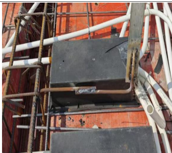
图 13-56 焊接部位搭接长度不足
