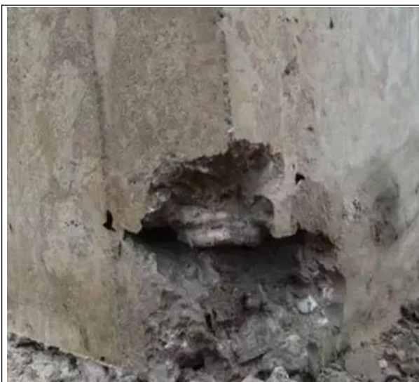
图 4-16 混凝土墙柱缺棱掉角缺陷
