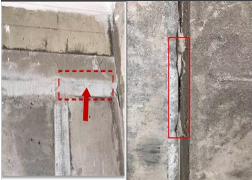
图 5-36 顶部、拼缝和转角、门头等部位出现开裂
